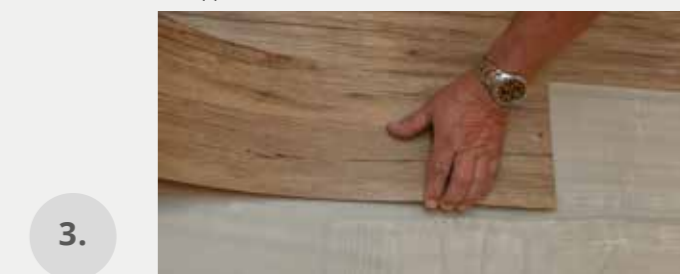
3. Pokládka vinylových dílců / laying vinyl tiles / Verlegung von Vinylteilen / Укладка деталей из винила / Pose de dalles vinylo
